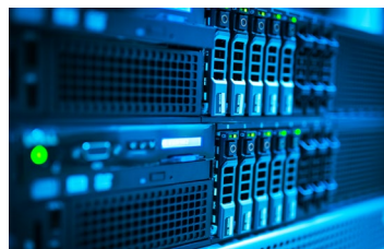
EDGE SERVER, DU
